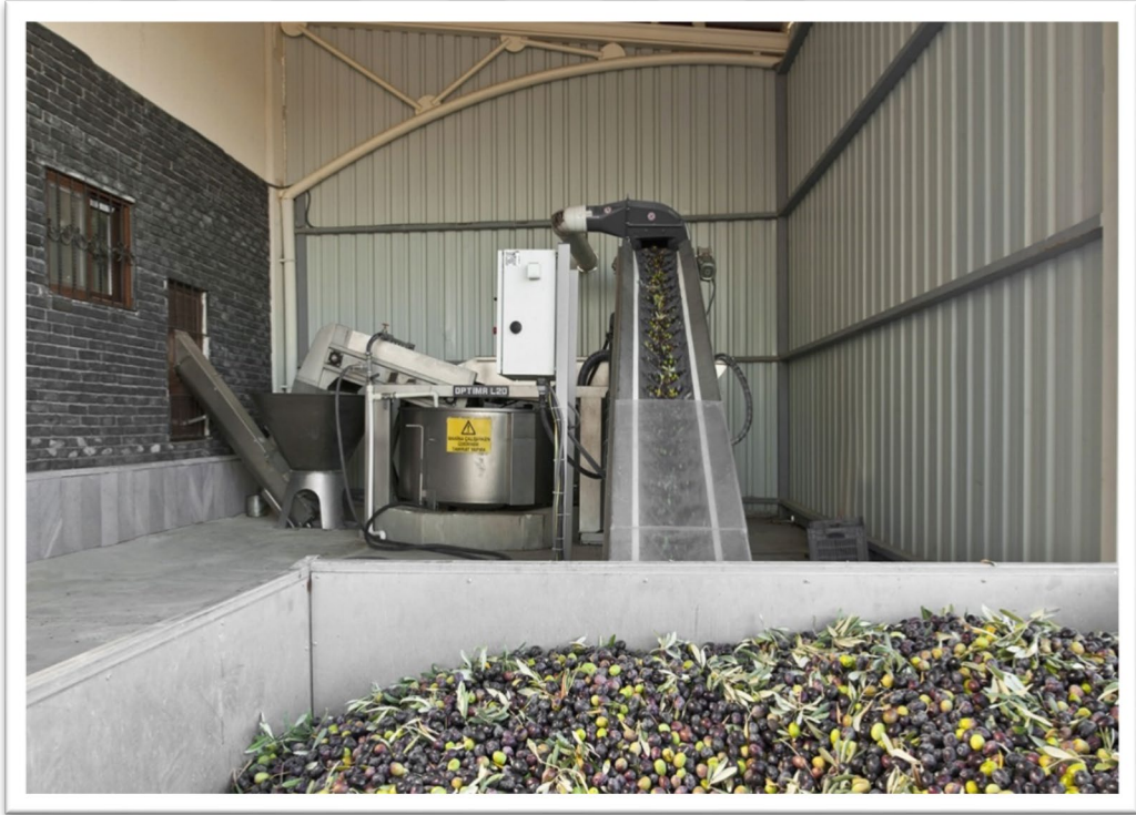
Fotoğraf 1. Zeytin Yıkama ve Temizleme Ünitesi
