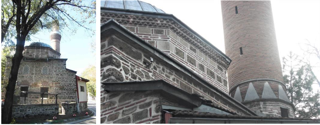
Şekil 5.18. İmaret-i İsabey Camii cephelerinde kararmalar.
