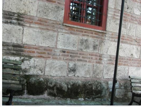
Şekil 5.28. Duvar eteğinde meydana gelen yosunlaşma.
