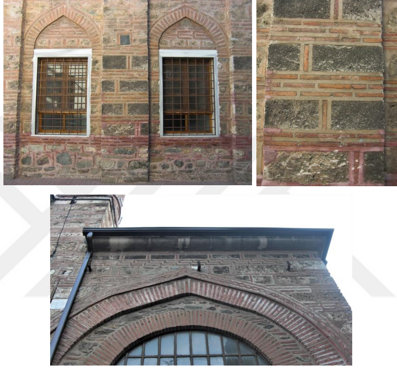
Şekil 5.14. Üftade Camii cephesindeki kararmalar.
