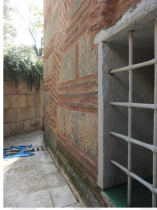
Şekil 5.25. Duvar diplerinde görülen bitki ve yosunlaşmalar.
