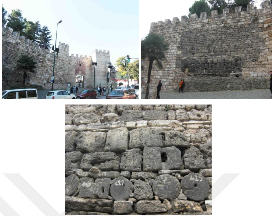
Şekil 5.5. Bazı kirliliklerin gözlemlendiği Saltanat Kapı'ya uzanan sur duvarı ve üzerindeki spoliyen malzemeler.
