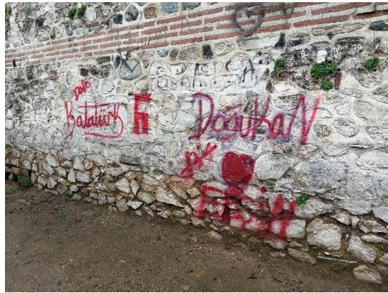
Şekil 2.24. Bursa surlarında sprej ve yağlı boya kirlilikleri.
