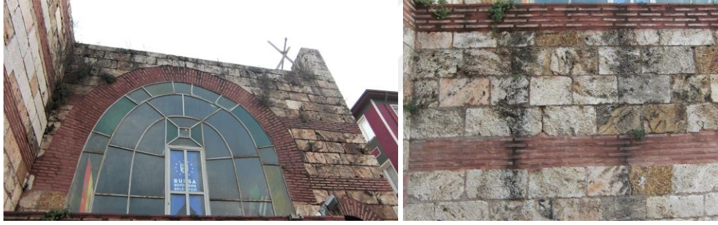
Şekil 5.11. Fetih Kapı'da yağmur suyu akıntısına bağlı kirlilik oluşumları.
