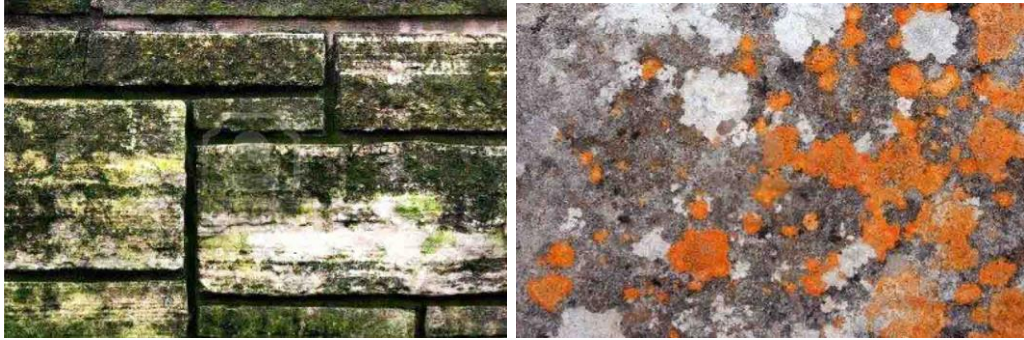
Şekil 2.20. Taş yüzeylerde mantar oluşumu (Dolar vd, 2014).
