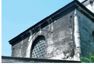
Şekil 2.15. Hava kirliliğine bağlı siyah kabuk oluşumu (Ersen, 2009).
