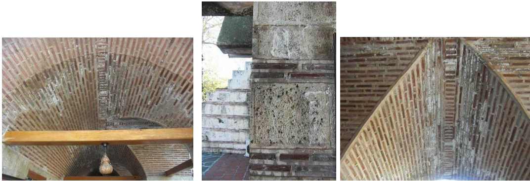
Şekil 5.32. Cephe, kemer ve tonoz üzerinde tuzlanma oluşumları.
