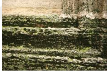
Şekil 2.13. Taş cephede görülen mikroorganizma oluşumları (Ersen, 2013).
