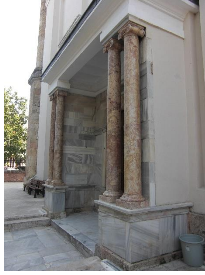
Şekil 4.7. Kuzey cephede yer alan mermer kaplamalar.
