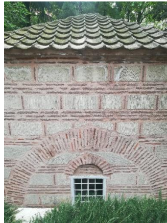
Şekil 5.27. Saçak ve saçak alt kısmında görülen tuzlanma.
