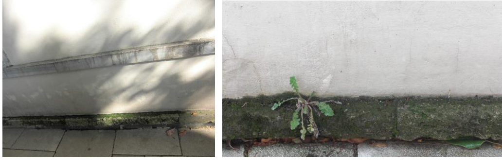
Şekil 5.23. Duvar eteklerinde meydana gelen bitki ve yosun oluşumları.
