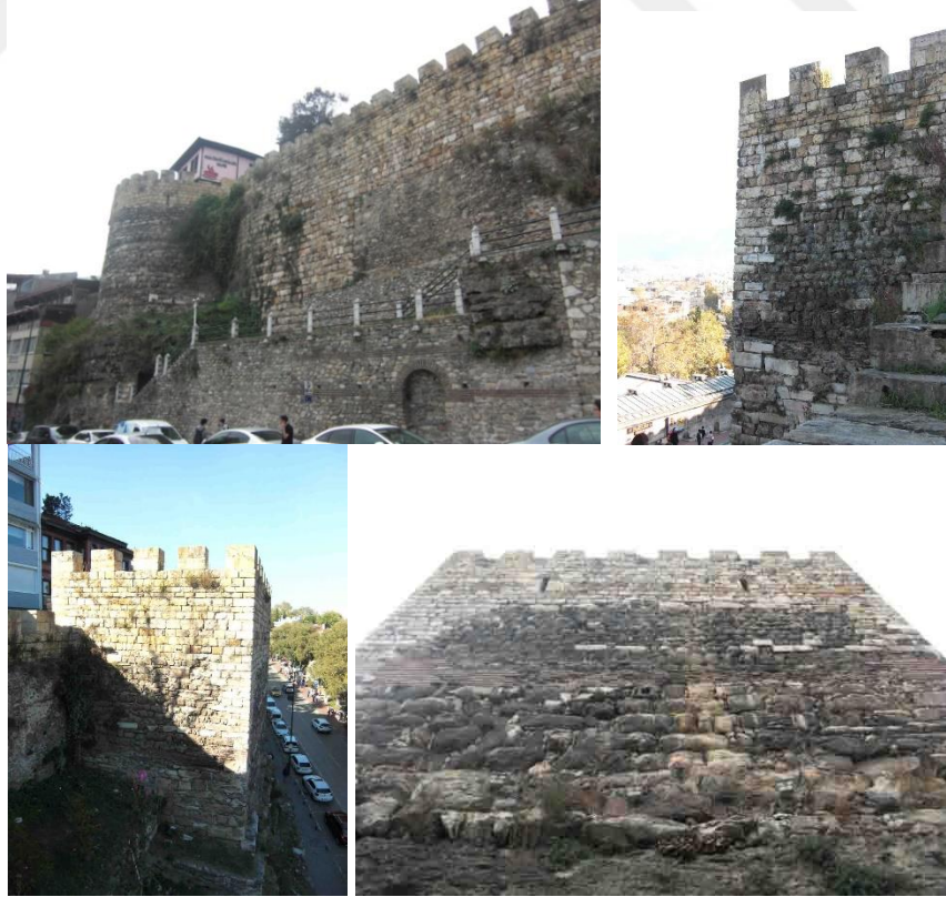
Şekil 5.3. Osmangazi caddesine paralel bir şekilde uzanan ve üzerinde bazı kirlilikler tespit edilen sur duvarları ve burç.
