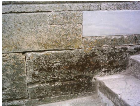
Şekil 2.22. Taş cephede yosunlaşma oluşumu, (Dal, 2010).
