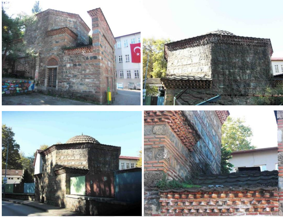
Şekil 5.37. Yapı üzerindeki bitki, yosun oluşumları, tuzlanma ve kararmalar.
