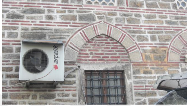
Şekil 5.20. İmaret-i İsabey Camii cephesindeki pas lekeleri.
