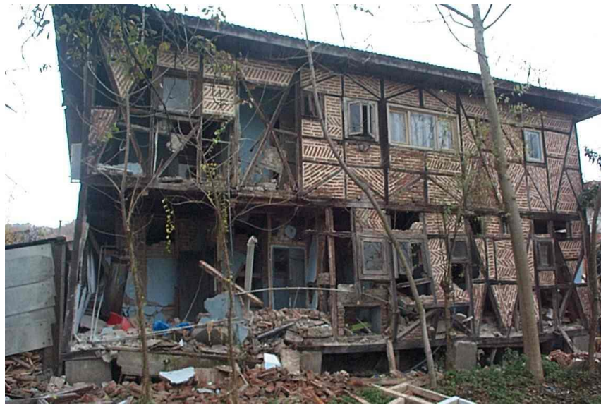
Şekil 3.27. 1999 Düzce depreminde hasar görmüş hımış ahşap yapı (DES, 1999).
