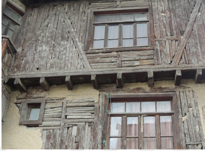
Şekil 3.23. Dizemelerin sıva tutamaması örneği (Güneş, 2014).
