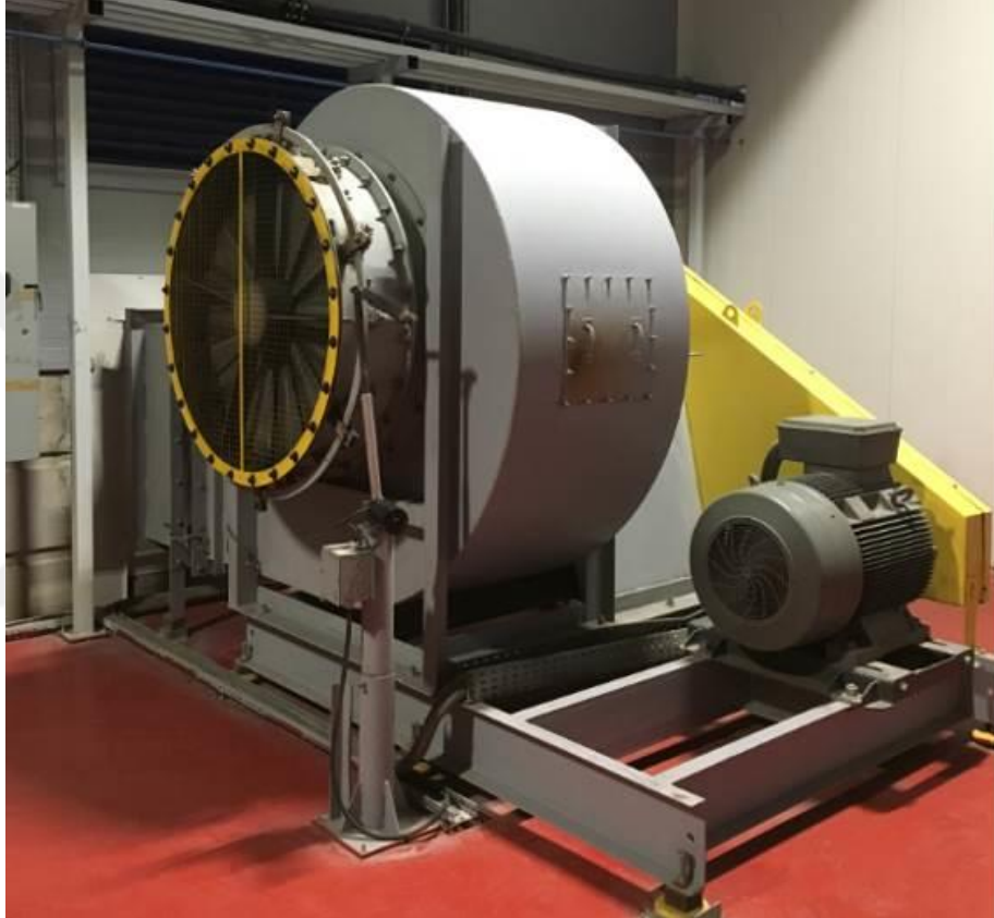
Şekil 7.9. Cooling elektrik motoru.
