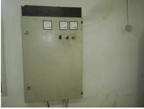
Şekil 6.4 Elektrikli Dinamometre Panosu
