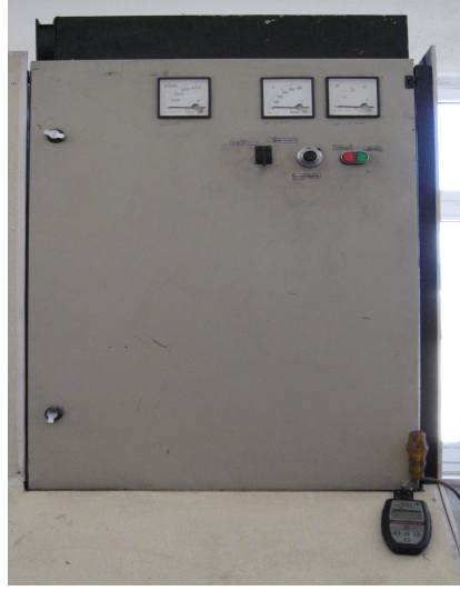
Şekil 6.5. Elektrikli dinamometre panosu.
