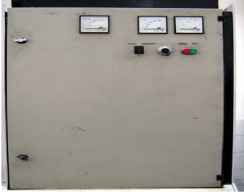
. Şekil 6.5. Kontrol ünitesi.
