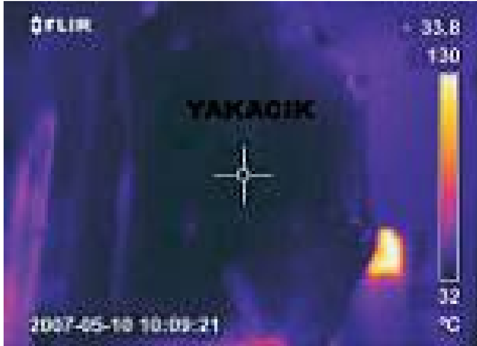
Şekil 4.6. Vana ceketi uygulamasından sonra yalıtımlı vananın termal kamera görüntüsü [25].
