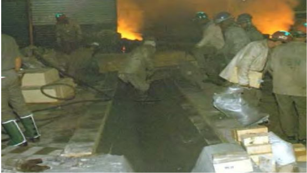
Şekil 4.8. ASC dövme malzemesi uygulanmış yüksek fırın kanalı [47].
