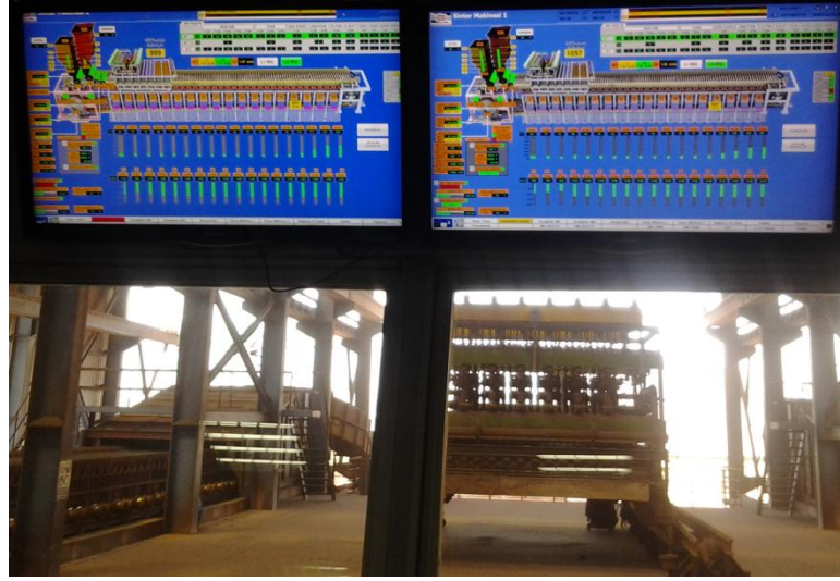
Şekil 4.1. Sinter ünitesi ve SCADA ekranları.
