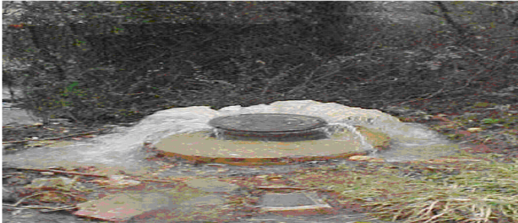
Şekil 6.3. Atık yağlardan dolayı tıkanan kanalizasyon [45].
