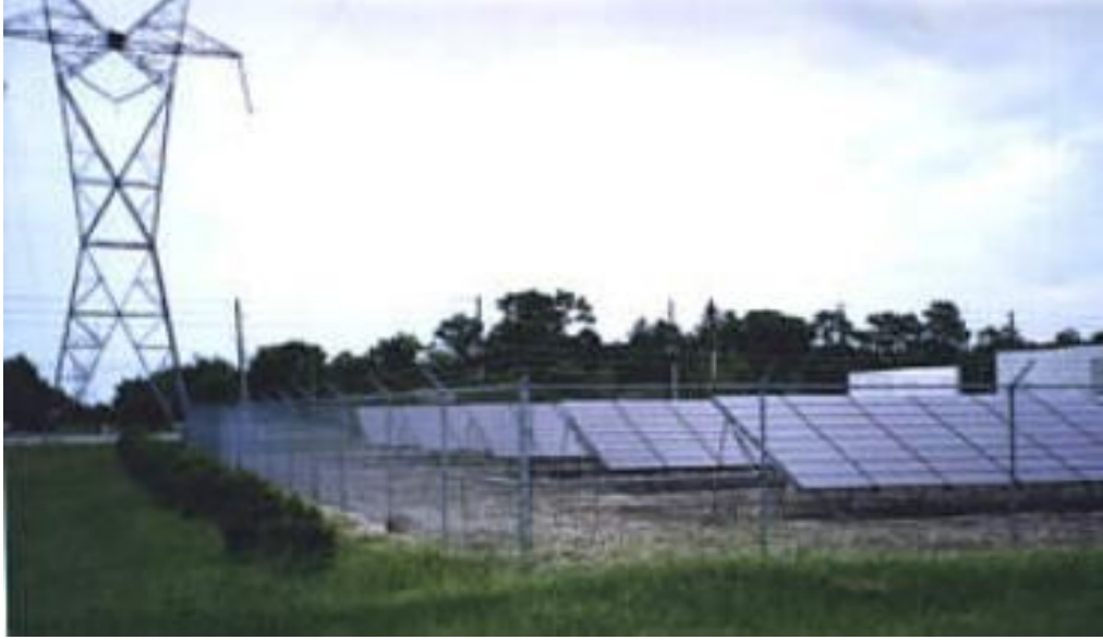
Şekil 3.6. Güneş pillerinden kurulan elektrik santrali.
