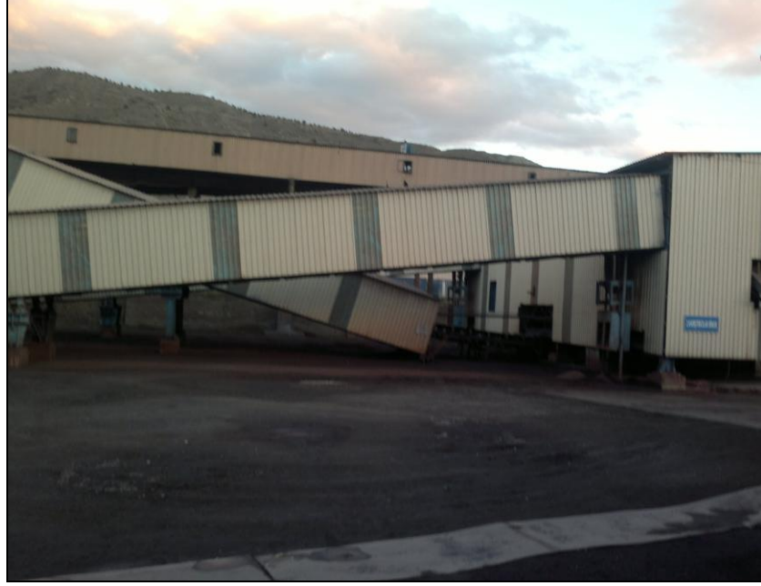
Şekil 2.8. Sinter Tesisi yatak malzemesi hatları.
