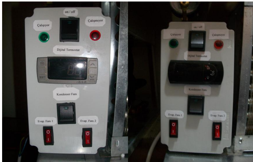
Şekil 4.5. Sistemde kullanılan elektrik panoları.
