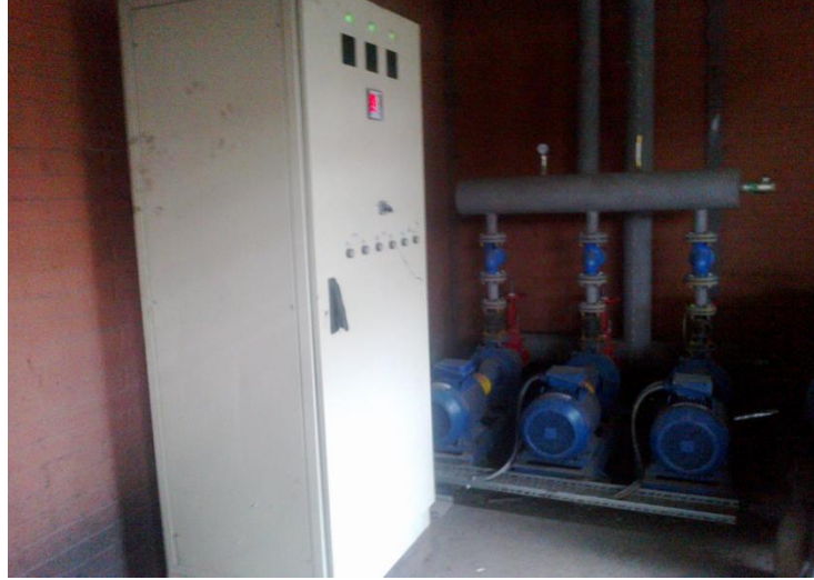
Şekil 3.13. Panel ve sirkülasyon pompaları.
