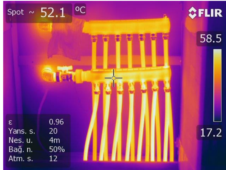
Şekil 7.19. A4 Cami'ne ait kalorifer tesisatından termal görüntü.
