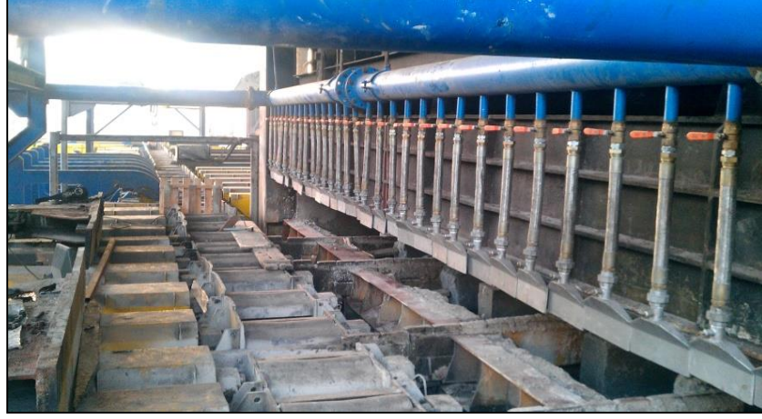
Şekil 3.10. Endüstriyel tav fırınında hava perdesi ile izolasyon.
