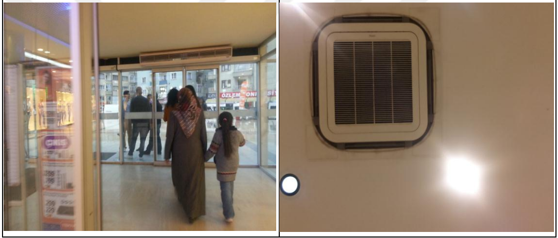
Şekil 5.58. Çankırı Yunus AVM'deki ısıtma-soğutma sisteminden bir görünüm.
