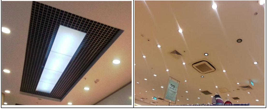
Şekil 5.57. Çankırı Yunus AVM'deki ısıtma-soğutma sisteminden bir görünüm.
