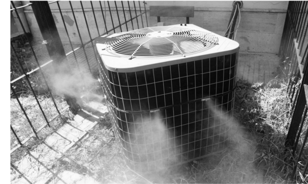
Şekil 4.1. Soğutma sistemi dış ünitesi ile sisleme sisteminin bütünsel görünümü.
