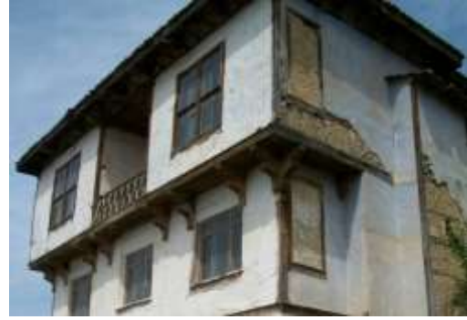
Şekil 3.135. Tescilsiz yapı balkon.
