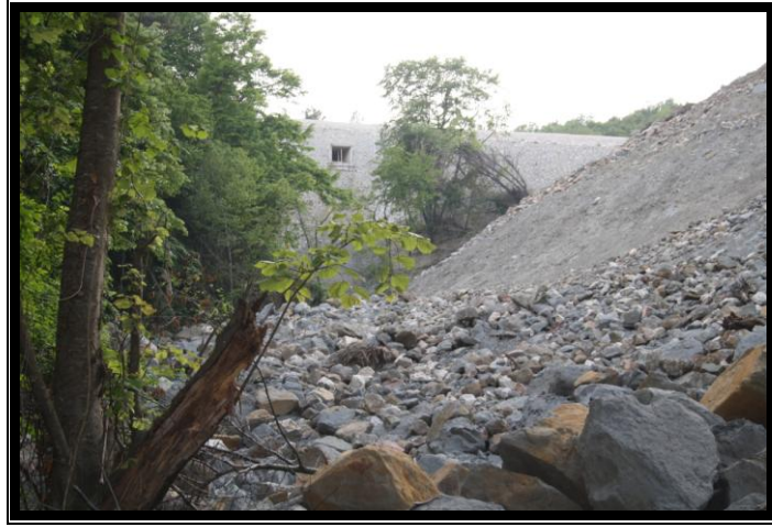
Şekil 4.4. Kemerdere Köprüsü yakınında tünel inşaatı tahribatı (2014) [21].
