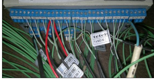
Şekil 4.11. Termokuplların data logger cihazı üzerindeki kanallara bağlantısı.
