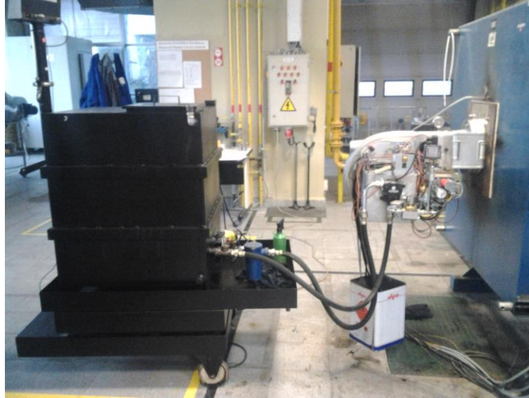
Şekil 5.43. Yakıt tankının brülöre ve brülörün de kazana bağlanmış görüntüsü.
