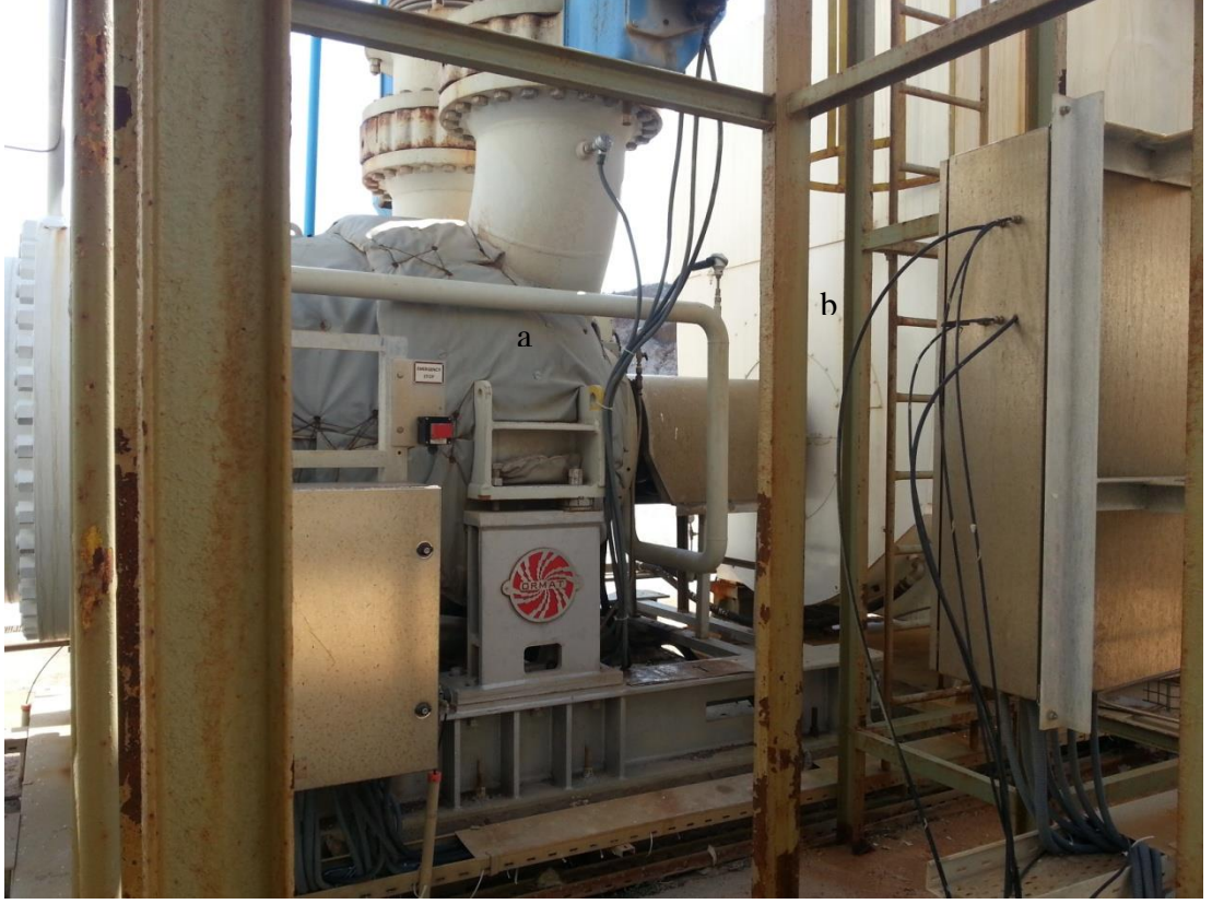
Şekil 5.3. Sistemde kullanılan a) türbin b) jeneratör.
