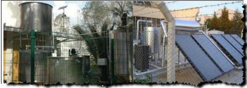
Şekil 1.2. Güneş enerjili biyogaz tesisi.
