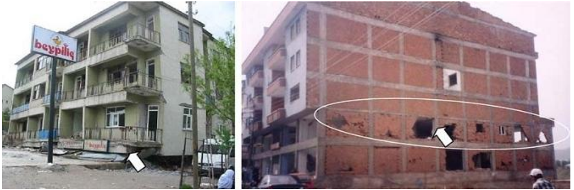
Şekil 3.5. Yumuşak kat düzensizliği nedeniyle oluşan yapısal hasarlardan görünümler (Doğangün, 2004).
