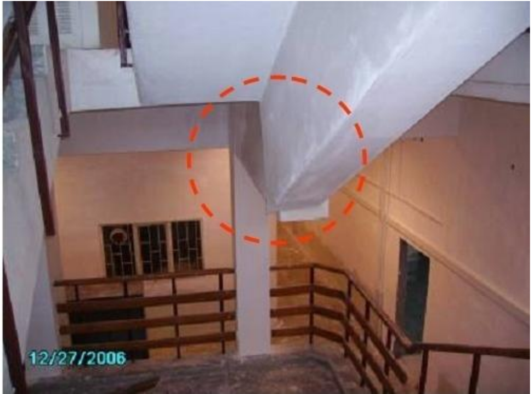
Şekil 2.20. Merdivenlerde oluşturulan yapısal hatalardan bir görünüm (Topçu, 2013).
