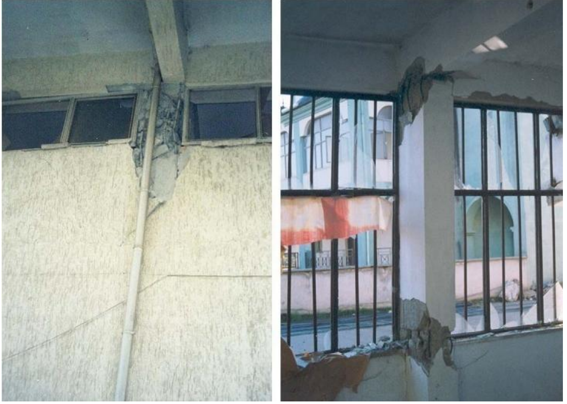
Şekil 2.17. Kısa kolon nedeniyle oluşan yapısal hasarlardan görünüm (Arslan ve Korkmaz, 2007).
