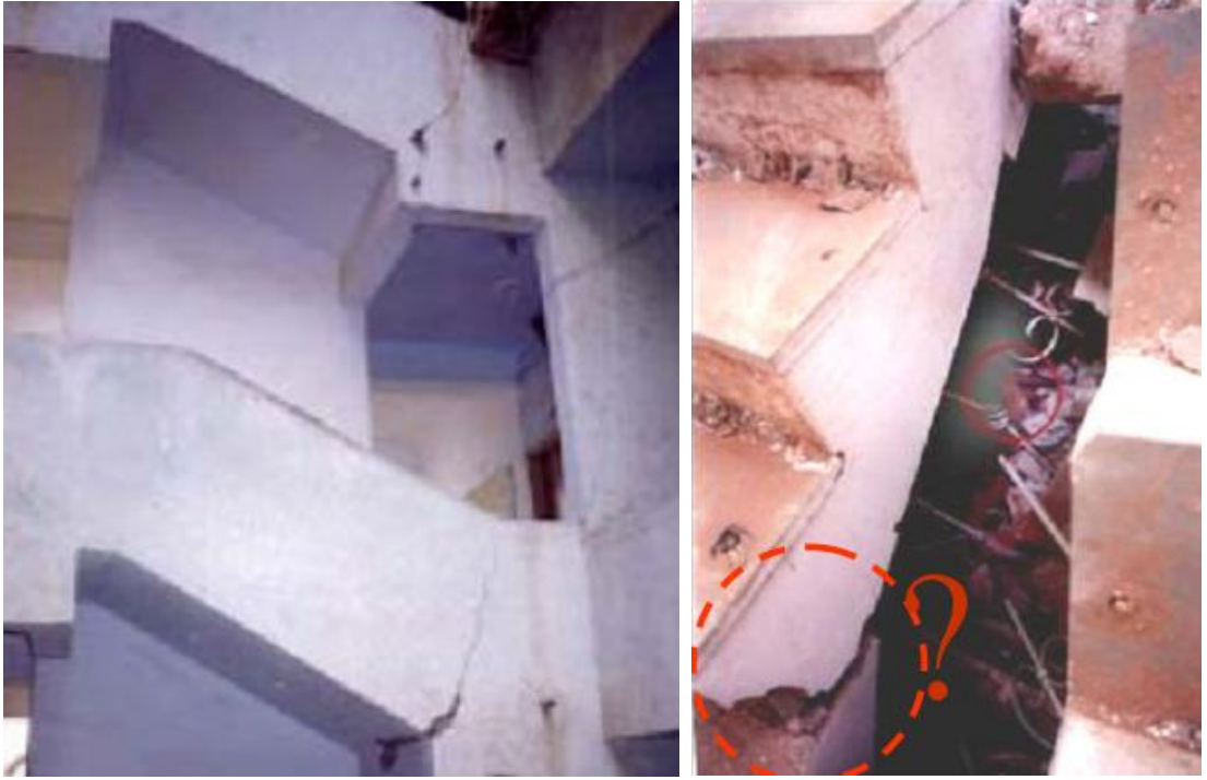
Şekil 2.19. Depremlerde merdivenlerde oluşan yapısal hasarlardan görünümler (Topçu, 2013).
