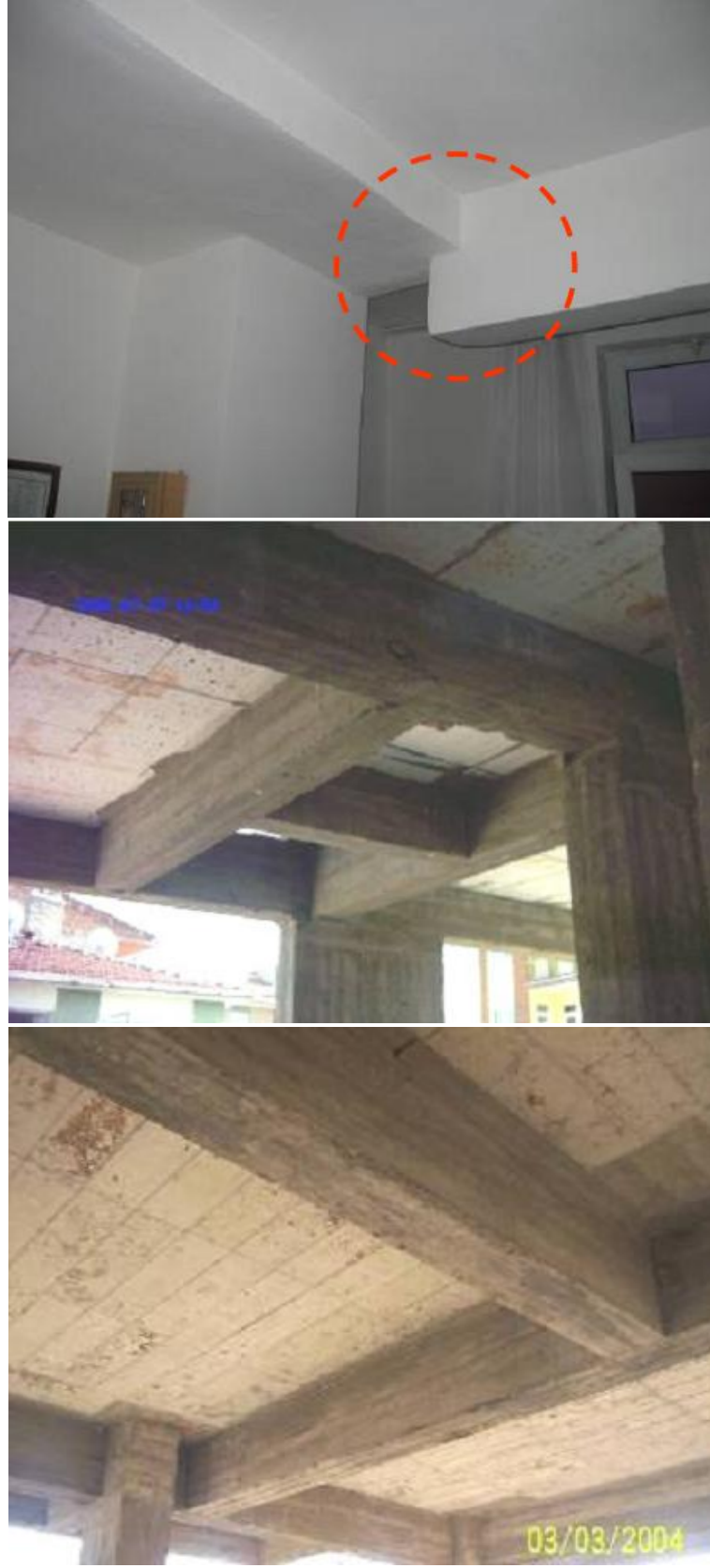
Şekil 2.11. Uygun olmayan kiriş bağlantılarından bazı görünüm (Topçu, 2013).
