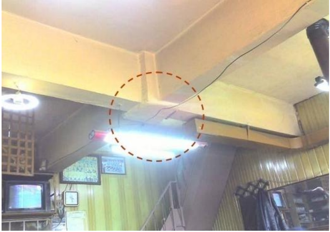
Şekil 3.3. Hacim kazanmak amacıyla kesilip kaldırılmış bir kolon örneği (Topçu, 2013).
