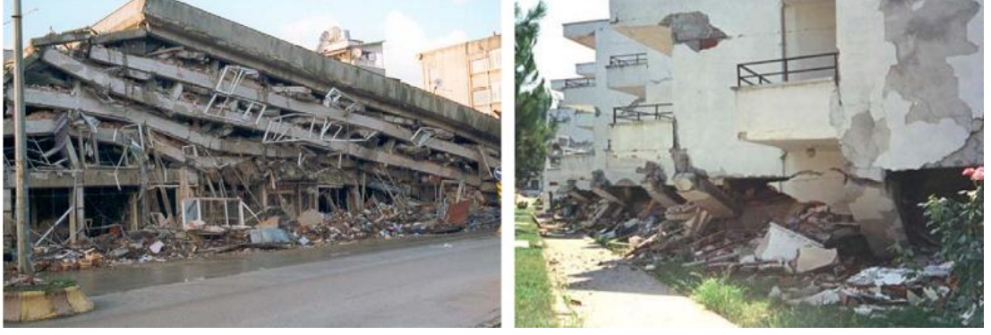
Şekil 2.7. Kuvvetli kiriş-zayıf kolon hasarlarından bazı görünüm (Arslan ve Korkmaz, 2007).
