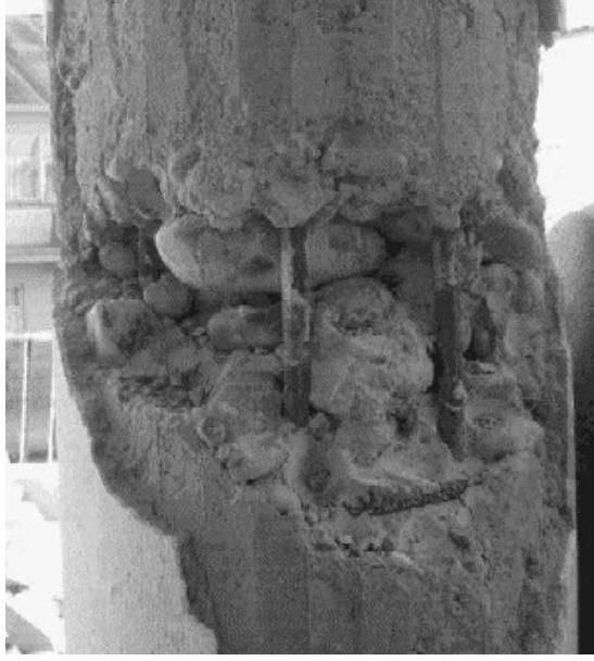
Şekil 2.14. Tekniğine uygun olarak yapılamamış beton yerleşimi nedeniyle oluşan yapısal hasardan bir görünüm (Kaplan vd. 2004).
