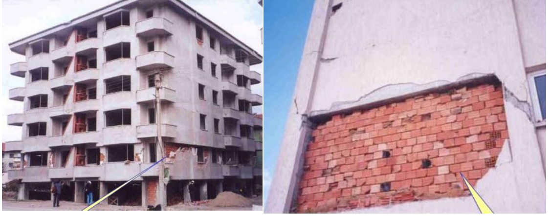
Şekil 2.18. Isı yalıtımı için yapılan iki yarım tuğla dolgu duvarların depremlerde oluşan hasarlarından bazı görünüm (Arslan ve Korkmaz, 2007).
