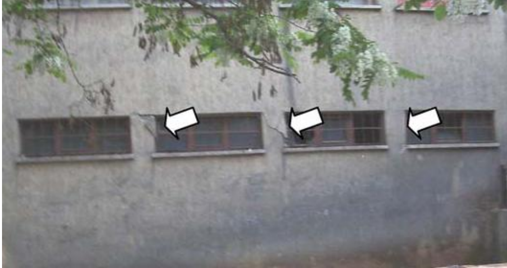
Şekil 2.16. Bant pencereler nedeniyle kısa kolon kesme hasarlarından görünüm (Doğangün, 2004).
