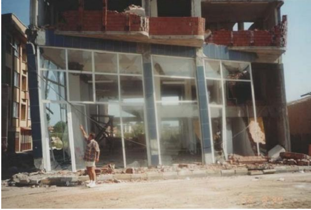
Şekil 3.2. 1999 Kocaeli depreminde Adapazarı'nda bir binada oluşan zayıf kat hasarından bir görünüm (Tezcan, 2007).
