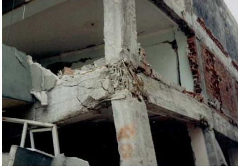
Şekil 2.12. Kolon-kiriş birleşim bölgesindeki etriye sıklaştırması yetersizliğinden dolayı oluşan yapısal hasardan bir görünüm (Arslan ve Korkmaz, 2007).
