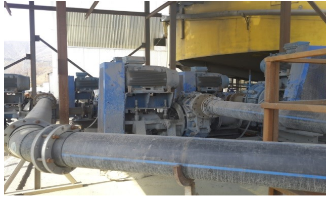
Şekil 3.9. Atık su pompaları.
