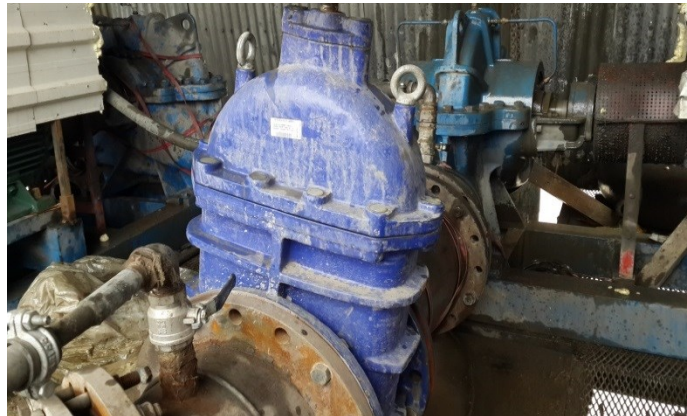
Şekil 3.10. Dere pompaları görünümü.
