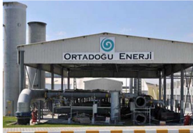
Şekil 10.12. Gaz iyileştirme ünitesi.
