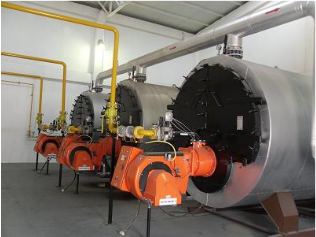
Şekil 4.1. Yeni RMS-A istasyonu gaz ısıtma için kullanılan ısıtma sıcak su kazanları.
