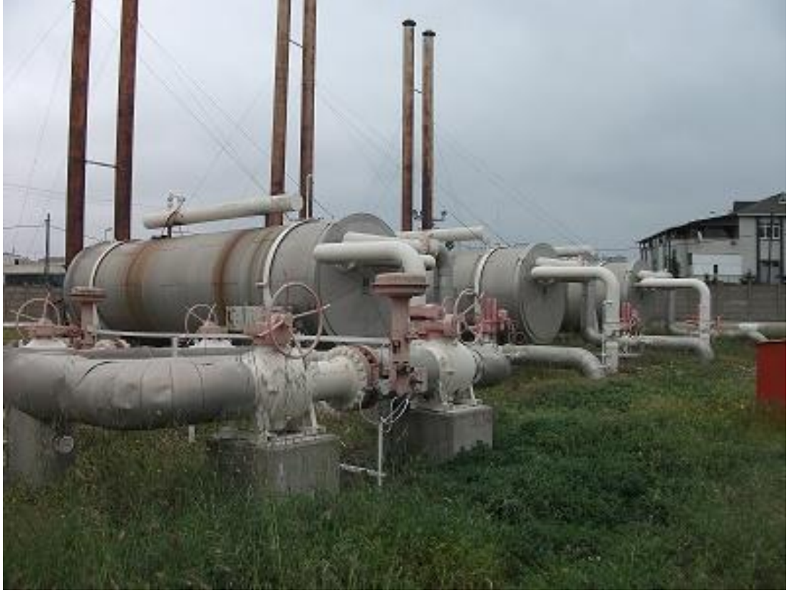
Şekil 4.10. Sahra tipi gaz ısıtma için kullanılan sıcak su kazanları.
