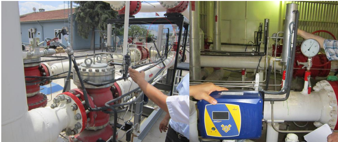
Őekil 4.5. Vorteks tüpü ile pilotların ısıtılması.
