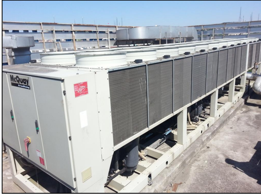
Şekil 4.6. Hastane soğutma grubu (Chiller).
