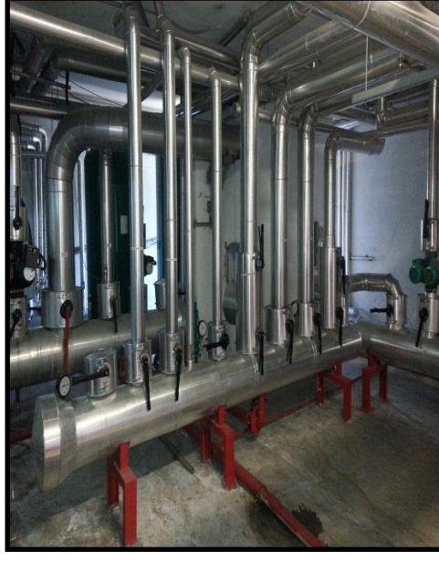
Şekil4.4. Hastane ana ısıtma dönüş kolektörü.
