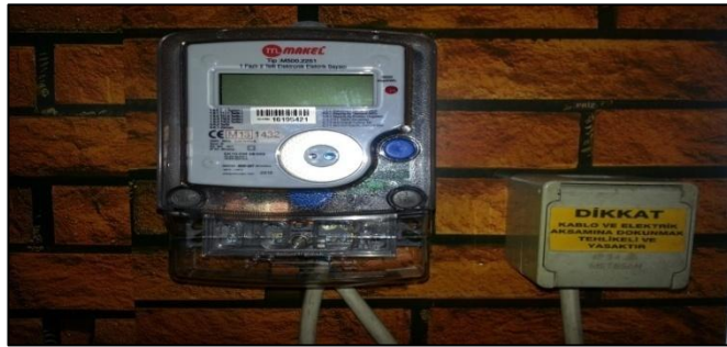
Şekil 4.12. Elektrik tüketiminin ölçülmesinde kullanılan elektrik sayacı.
