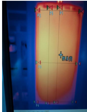
Şekil 4.21. Termal kamera dış yüzey sıcaklık değerleri.
