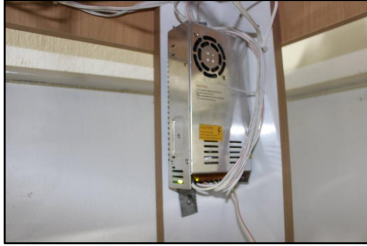
Şekil 6.2. Kesintisiz güç kaynağı.
