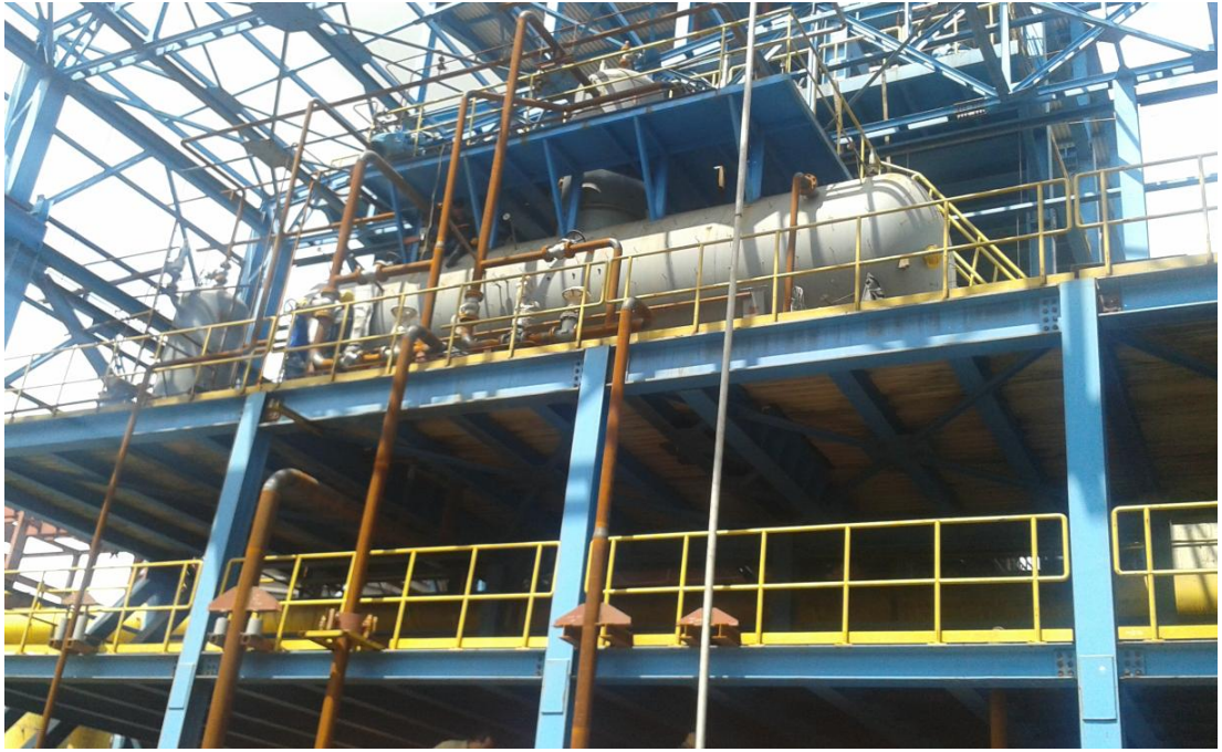
Şekil 3.8 Besleme deposu ve degazör genel görünüşü.
