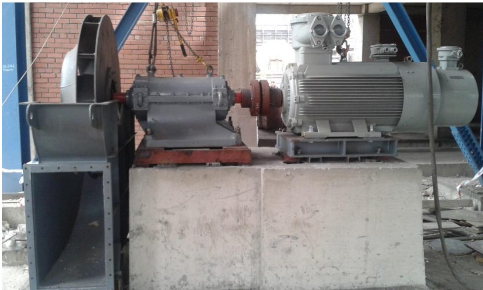
Şekil 3.13.Vantilatör genel görünüşü.
