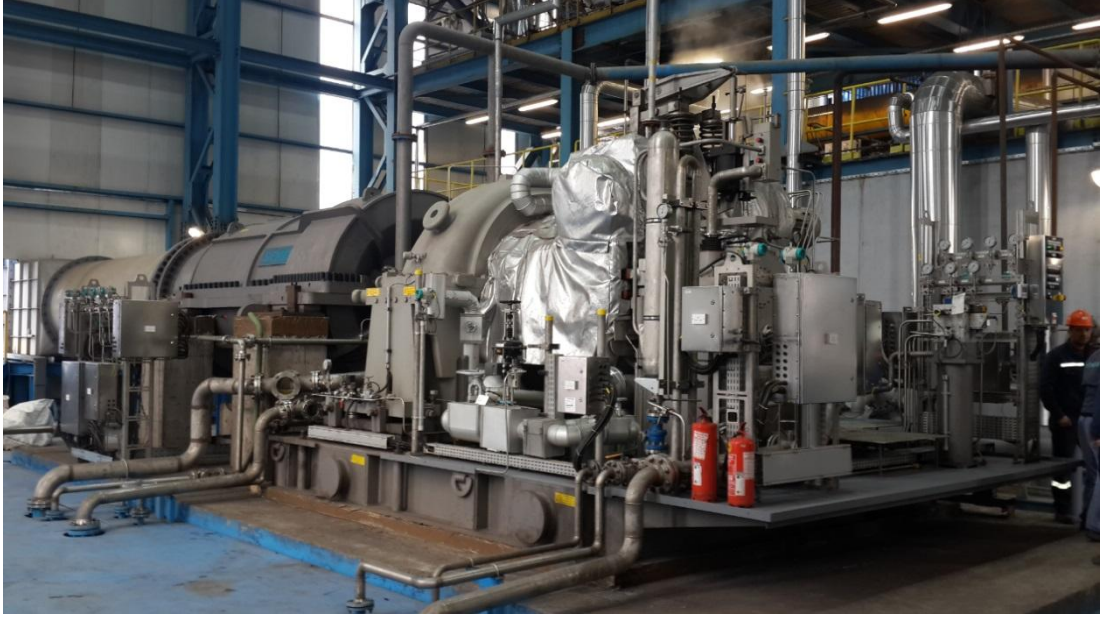
Şekil 3.5. Buhar türbini ve kompresör genel görünüşü.
