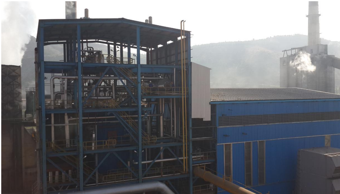
Şekil 3.4. Buhar kazanı genel görünüşü.
