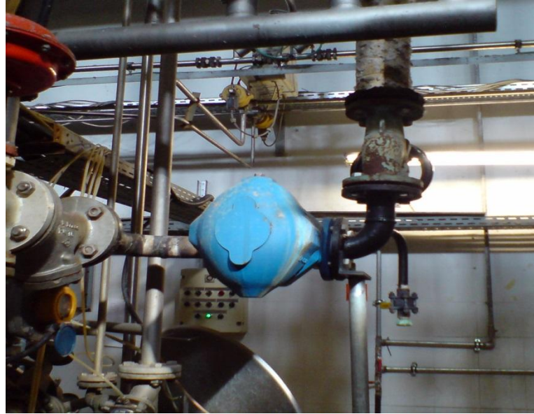
Şekil 5.4. Tekstil işletmesindeki tesisatta izolasyonun durumu.
