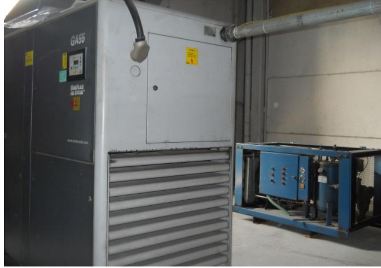
Şekil 5.12. Tekstil işletmesindeki mevcut kompresör sistemi.
