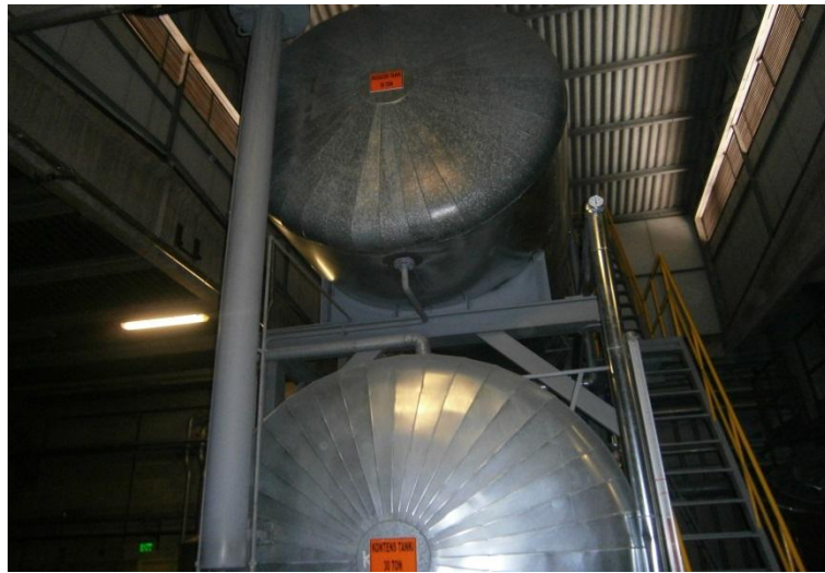
Şekil 5.6. Tekstil işletmesindeki kondens tankı ve buhar degazörü.
