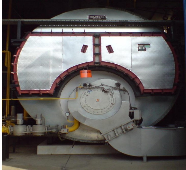
Şekil 5.1. Tekstil işletmesindeki mevcut buhar kazanı.
