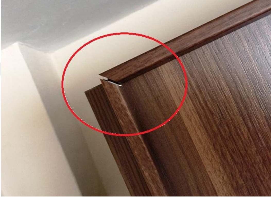
Şekil 5.2. Montajdan kaynaklanan problem.
