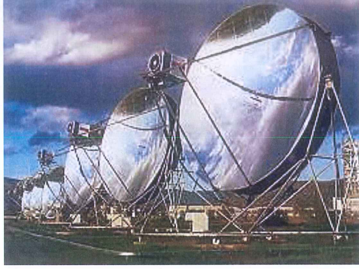
Şekil 2.6. Parabolik çanak güneş ısı elektrik santrali (Karamanav, 2007).
