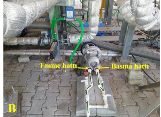
B) Blower yardımı ile depodan jeneratöre biyogaz gönderimi
