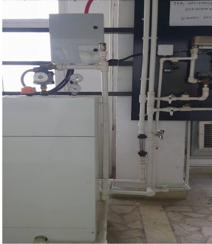
Şekil 3.11. Kapı önü sıcak su hazırlama sistemi.
