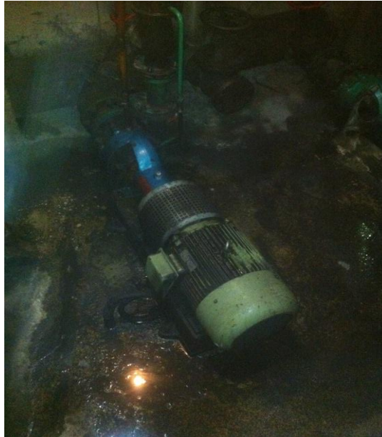
Şekil 3.7. 1 No'lu Shaangu turbo körük kondens pompası.
