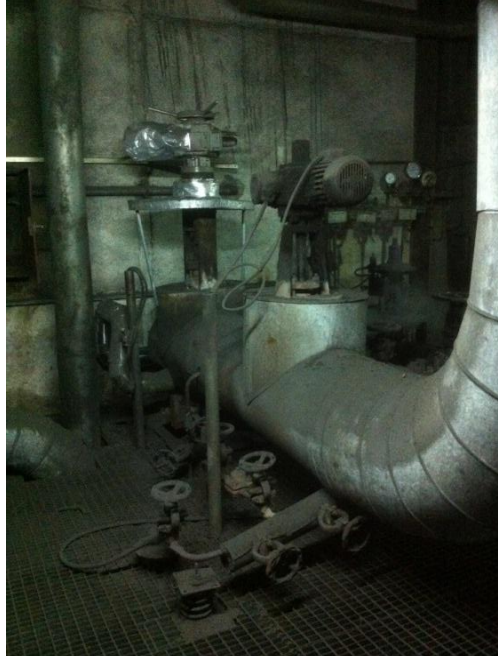
Şekil 3.8. RS-1 Sıcaklık ve basınç düşürme istasyonu.
