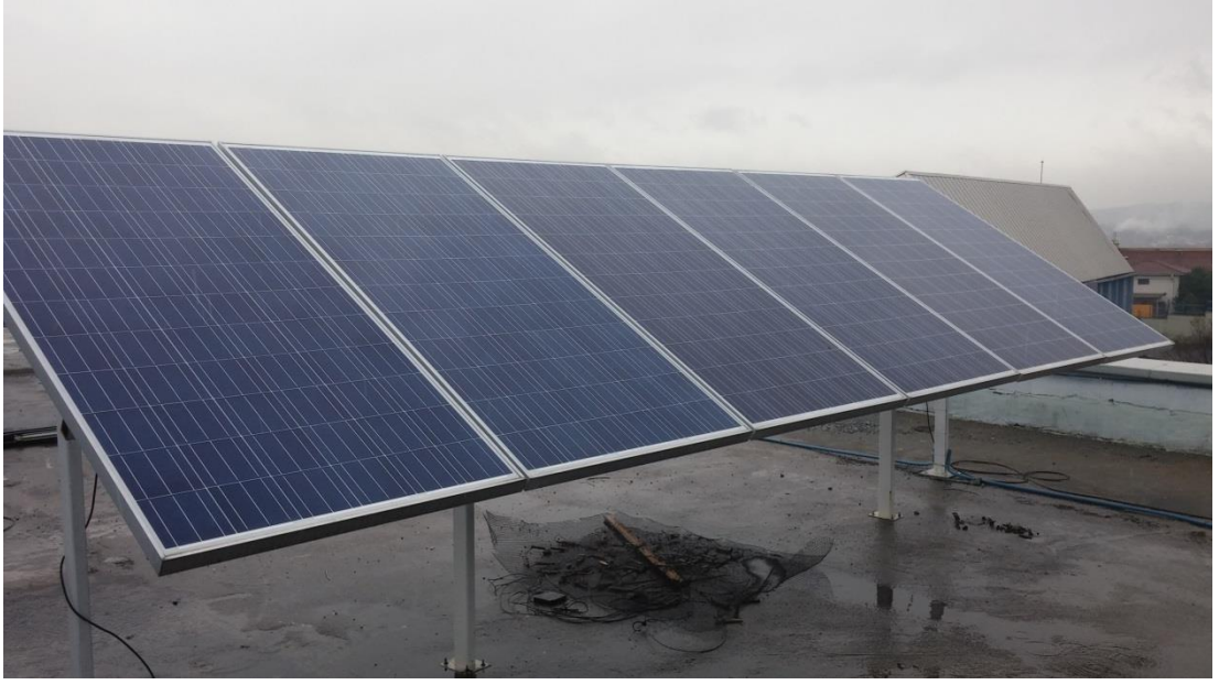
Şekil 5.1. KBÜ Yenilenebilir Enerji Merkezi'nde bulunan PV sistem.
