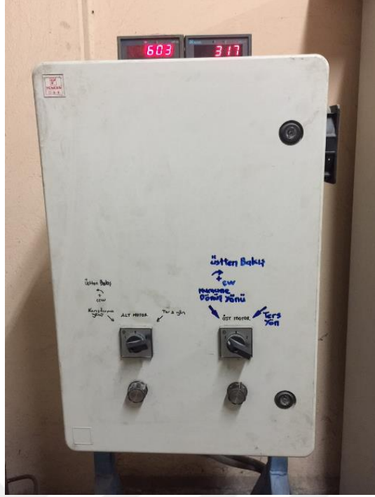
Şekil 6.3. Deney düzeneğinde kullanılan elektrik motorlarının sürücü ve elektrik panosu görüntüsü.
