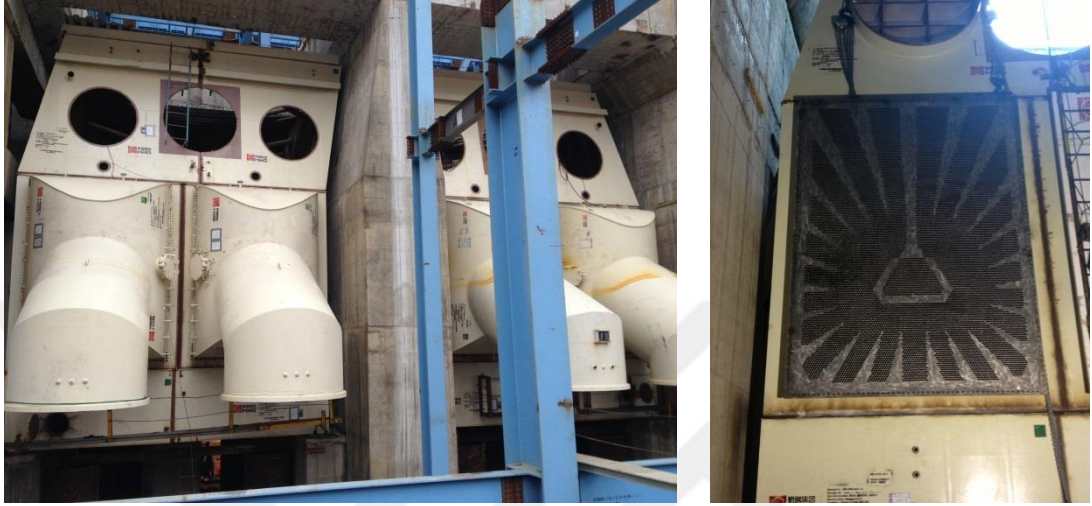
Şekil 4.6. Kondenser genel görünüşü ve iç yapısı.
