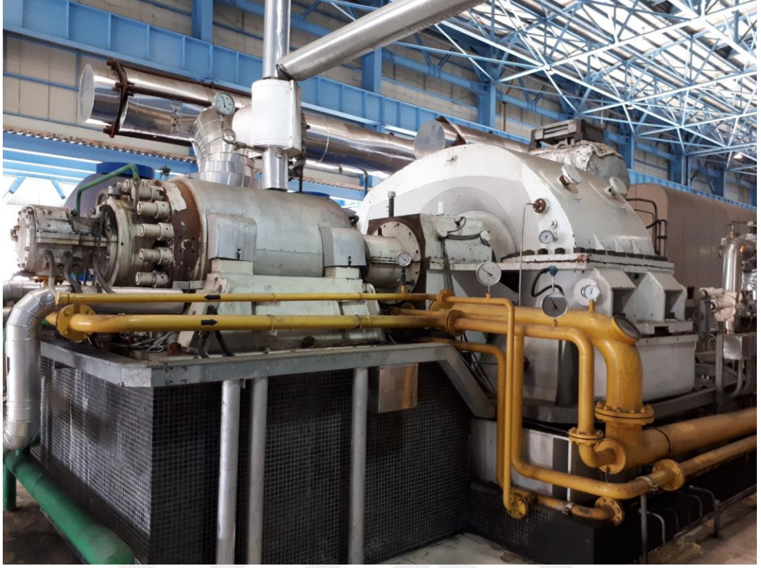
Şekil 4.11. Kazan besleme suyu pompası ve türbini.
