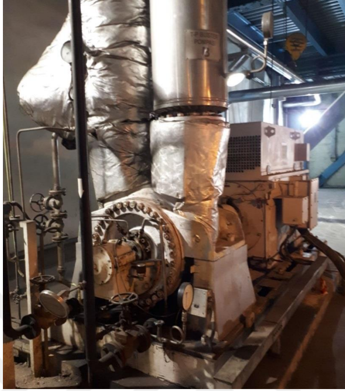
Şekil 4.10. Booster (yardımcı) pompa.
