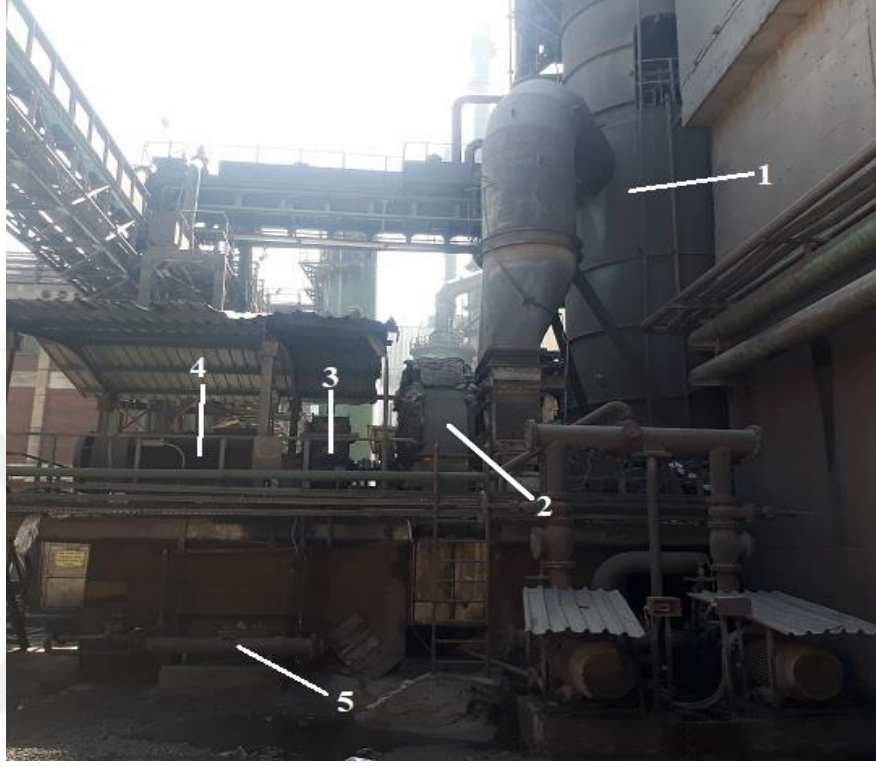
Şekil 4.2. KARDEMİR A.Ş. çelik üretim tesisinde 3 numaralı BOF, BOF gazı taşıma sisteminde kullanılan ID fan ve temel ekipmanların genel görüntüsü.
