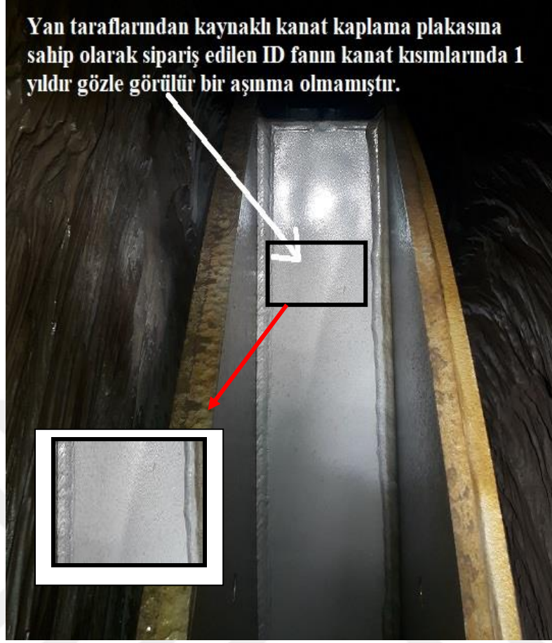
Şekil 4.12. ID fan kanatlarına AISI 304L kanat kaplama plakasının yanlardan kaynaklı montaj yapılmış haliyle ID fan kanatlarında 1 yıllık çalışma sonucunda gözle görülür bir aşınma olmadığına görüntüsü.
