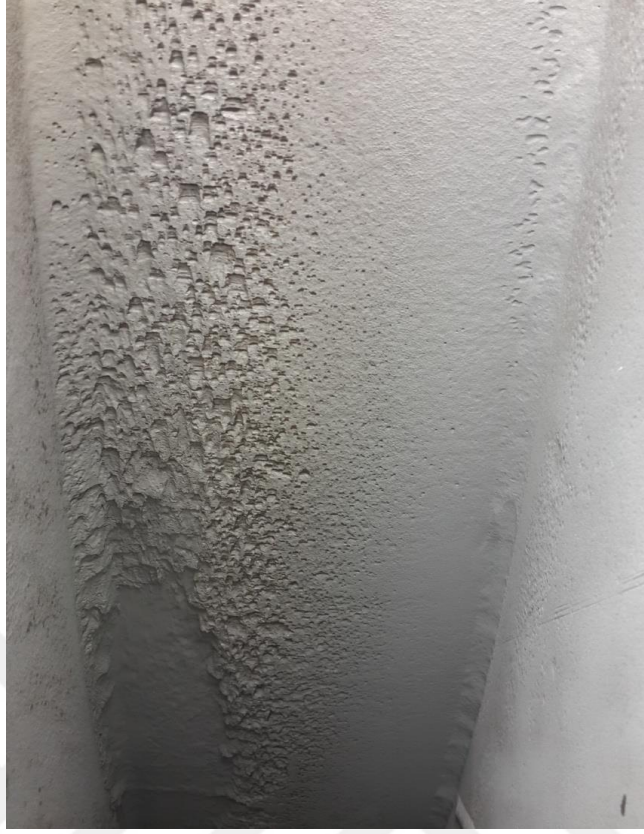
Şekil 4.6. ID fan kanatlarında oluşan aşınmanın yakın görüntüsü.
