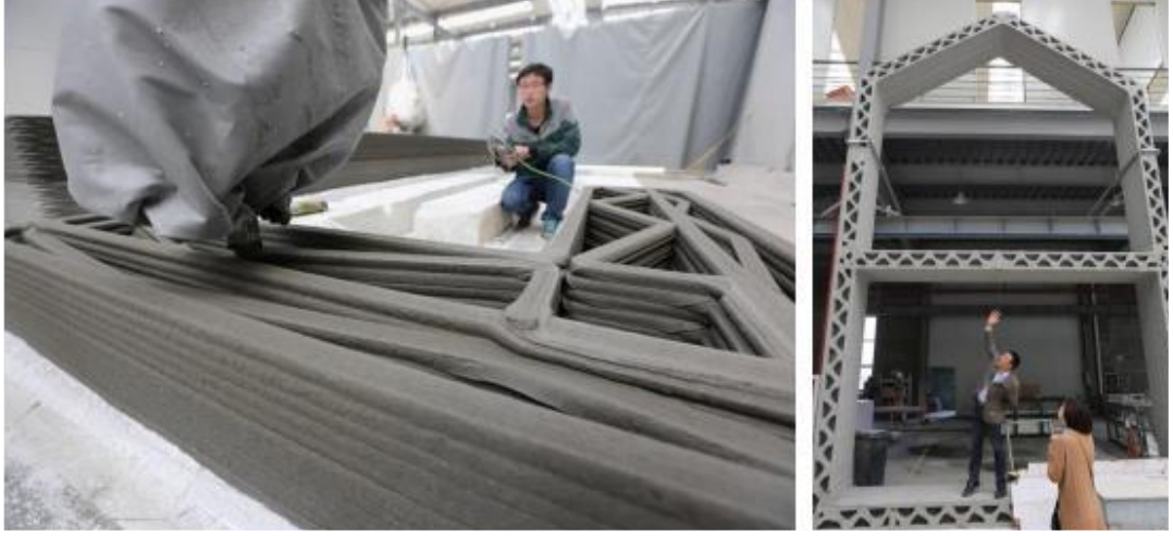
Şekil 4.12. İlk üç boyutlu katmanlı teknolojiler ile çimento-cam yünü bazlı malzemeden yapı üretimi örneği [39].
