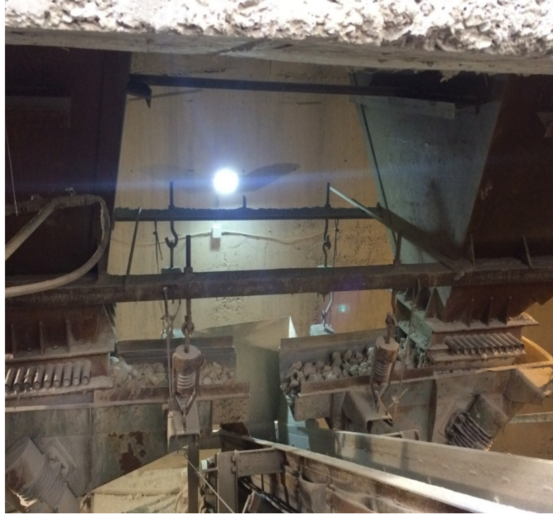
Şekil 3.3. Yer altı kireç taşı bunkerleri vibratörlerin genel görünümü.
