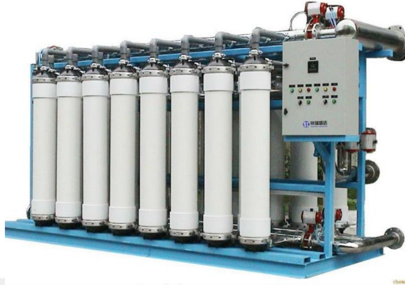
Şekil 3. 13. Elektro kaplama uygulamasında ultrafiltrasyon sistemi.
