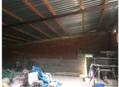
c) Özgün olmayan çatı ve duvar
