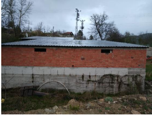
a) Karıt Değirmeni özgün olmayan tuğla duvar müdahalesi.
