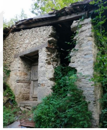
c) Ön cephe yıkılan duvar kısmı.
