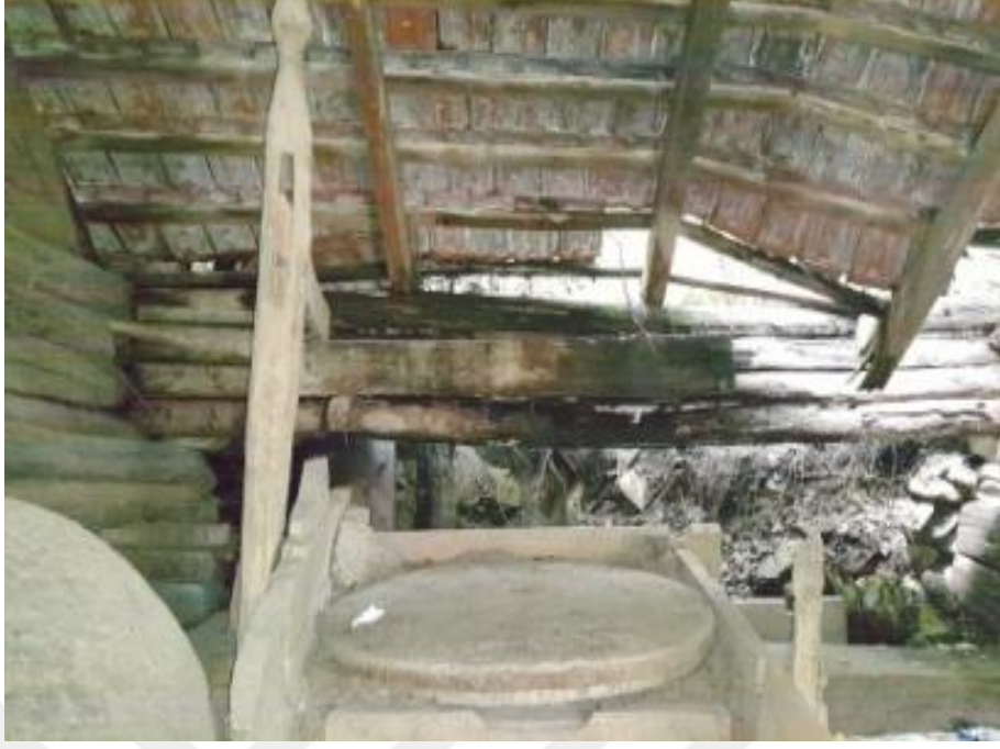
Şekil 4.7. Akkışla Köyü Değirmeni yıkılan duvarı.
