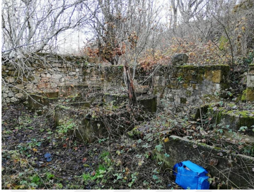
Şekil 4.43. Çıraklar Köyü Hacı Abdullah Değirmeni üç adet değirmen düzeneği ve yıkılmış çatı örtüsü ile değirmenin taş beden duvarları.
