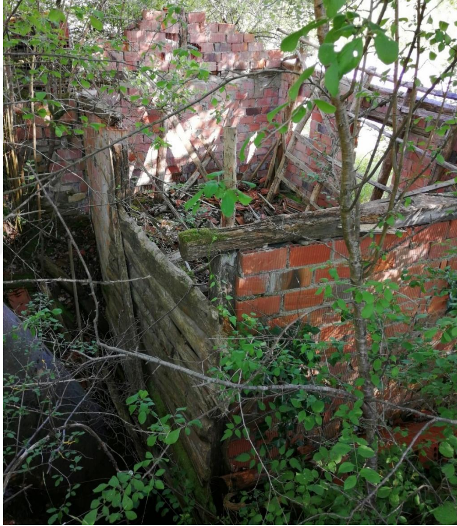
a) Değirmen yıkılan çatısı ve özgün olmayan tuğla duvarları.
