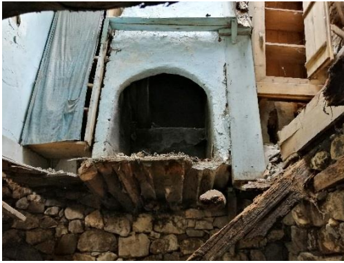
a) Zemin kısmı çöken oda.
