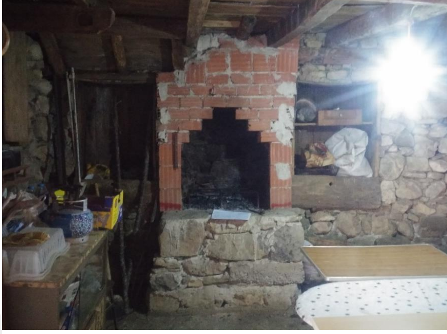
Şekil 4.31. Özgün olmayan tuğla malzeme ile inşa edilmiş ocak.
