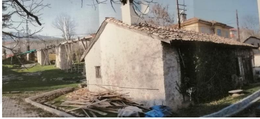
Şekil 3.10. Safranbolu Merkezinde yer alan Bağlar Değirmenininin 2001 yılına ait restorasyon yapılmadan önceki fotoğrafları.
