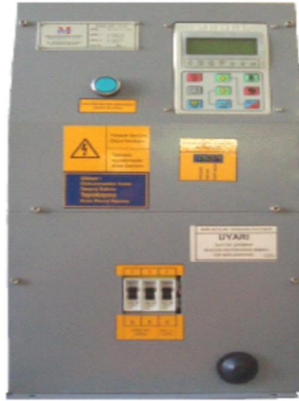
Şekil 3.4. İnverter ünitesinin görüntüsü [17, 20].
