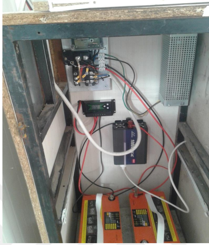
Şekil 5.5. Türbin sistemi kontrol ünitesi.
